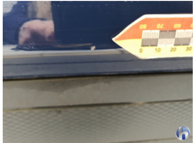
1. Tür Hinten - Links Gebrauchsspuren - Ohne Reparatur
