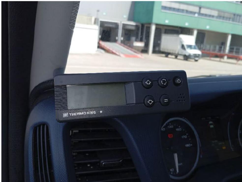
Bild: 11 Kühlsteuerung mit Überwachung
