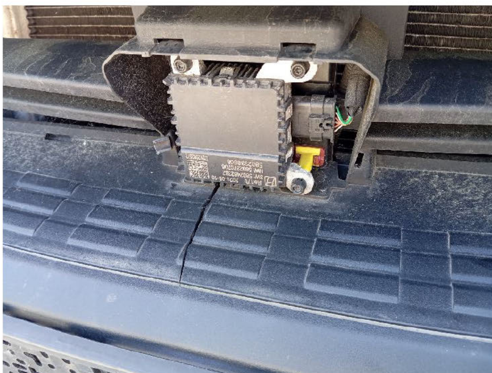
Bild: 14 Frontstoßfänger gebrochen/ Halter Abdeckung Radarsensor gebrochen/ Abdeckung fehlt
