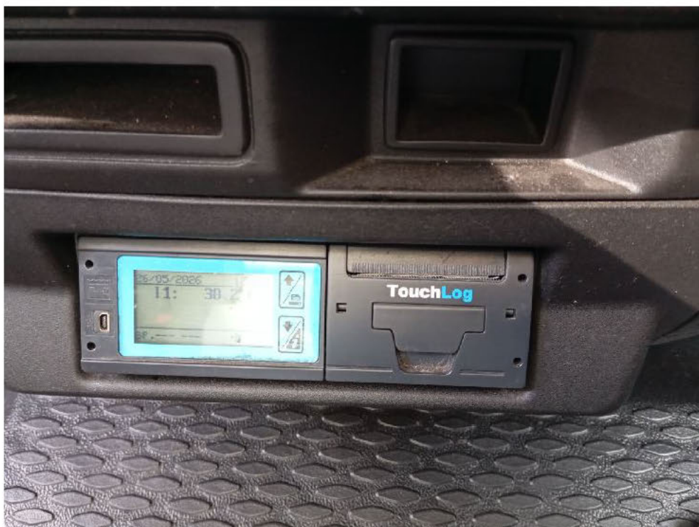
Bild: 10 Kühlsteuerung mit Überwachung
