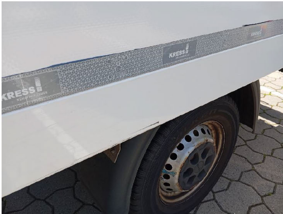
Bild: 25 Seitenwandabschlussprofil verkratzt
