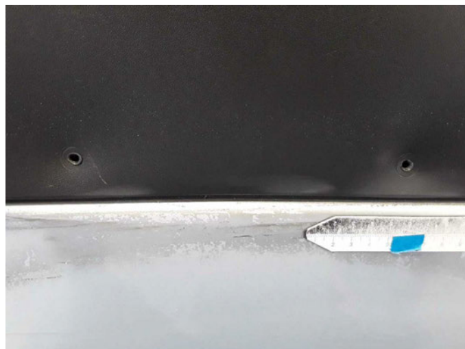
Beschädigung 11: Seitenwand rechts: Schutzleiste - beschädigt - erneuern
