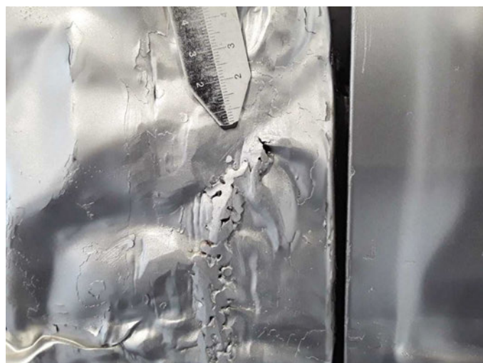
Beschädigung 12: Seitenwand rechts: Seitenwand - beschädigt - erneuern
