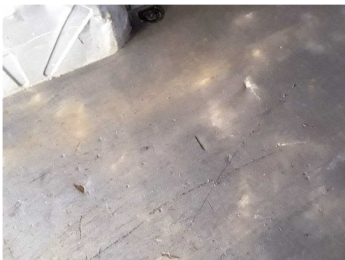
Beschädigung 3: Interieur: Innenraum (Feuchtigkeit geruch) - verschmutzt - kein Abzug
