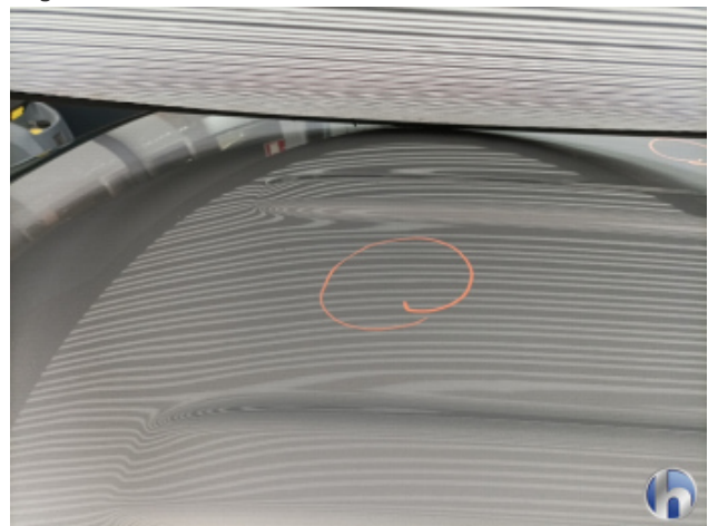
1. Dach Hagelschaden - Sanft Instandsetzen
