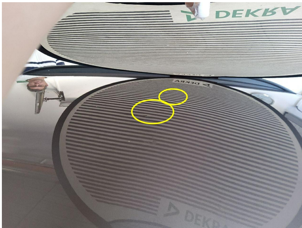
Bild 9 : Dach mehrfach eingedellt
