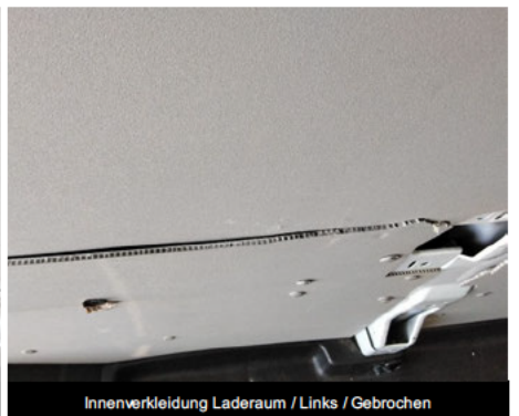
Innenverkleidung Laderaum / Links / Gebrochen
