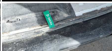
Junta de marco de puerta / Trasero / Roto
