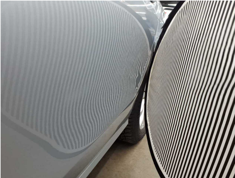
Beschädigung #21: Tür hinten links: Tür (Wellig und Einschlüsse im Lack) - nicht fachgerecht instandgesetzt - instandsetzen und lackieren
