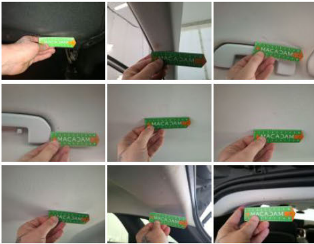
Ciel de toit, Déformé / Forcé, Réparer/rempl. (montant forfaitaire)
