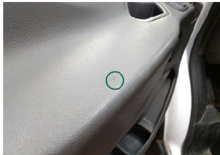
Türverkleidung / Vorne Links / Brandstelle
