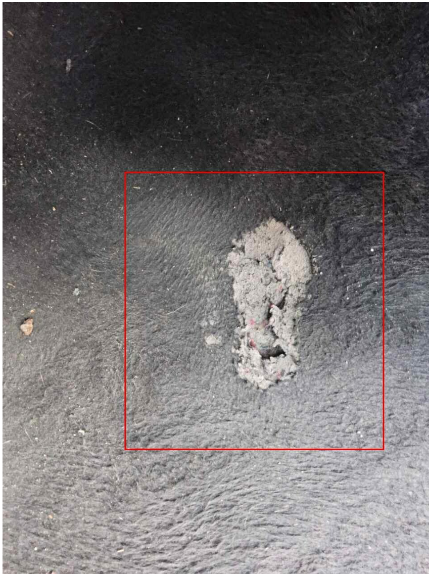
Bild 31 : Bodenbelag vorne, gerissen
