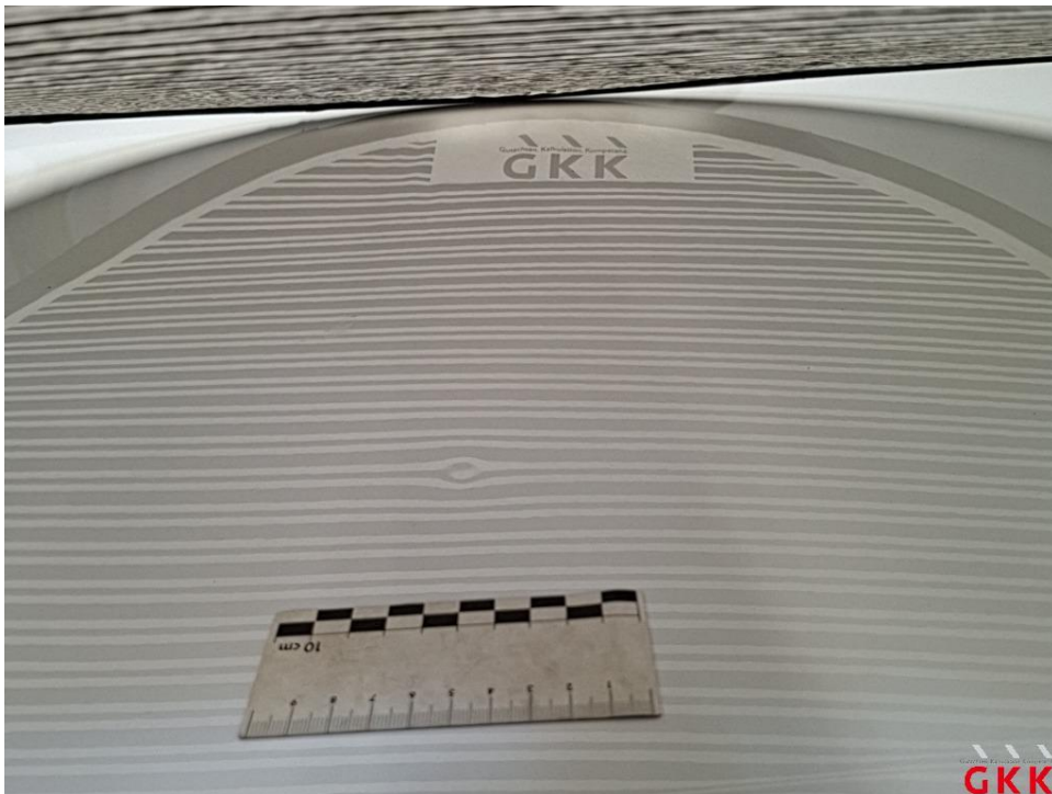
Bild 24 Dach, beschädigt, kalt drücken
