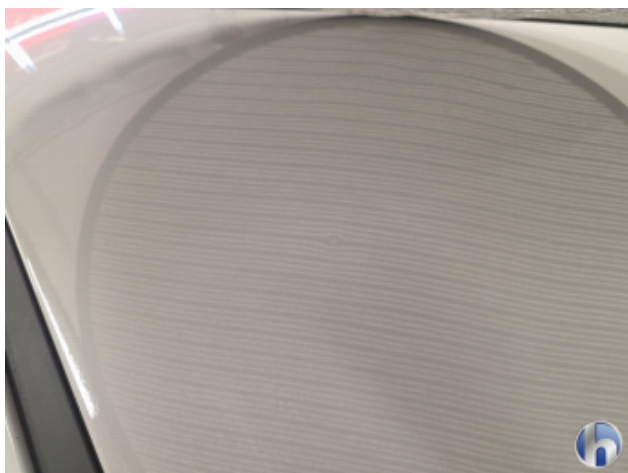
2. Dach Hagelschaden - Sanft Instandsetzen
