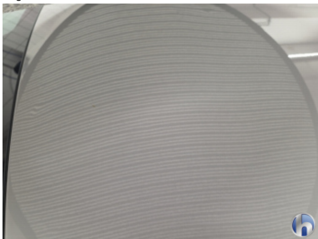
2. Dach Hagelschaden - Sanft Instandsetzen
