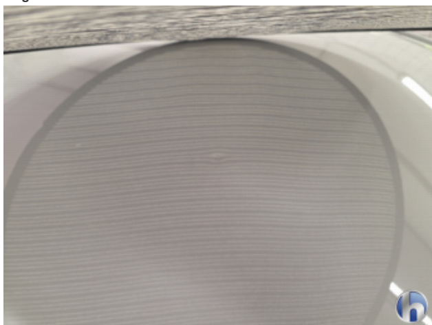
2. Dach Hagelschaden - Sanft Instandsetzen
