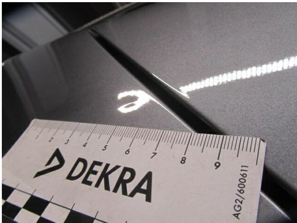
Bild 24 : Seitenteil hinten rechts, mehrfach eingedellt, drücken
