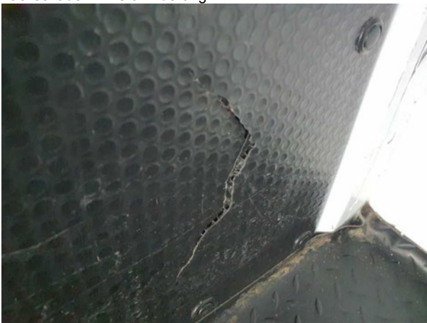
Beschädigung #7: Seitenwand links: Innenverkleidung - beschädigt - erneuern
