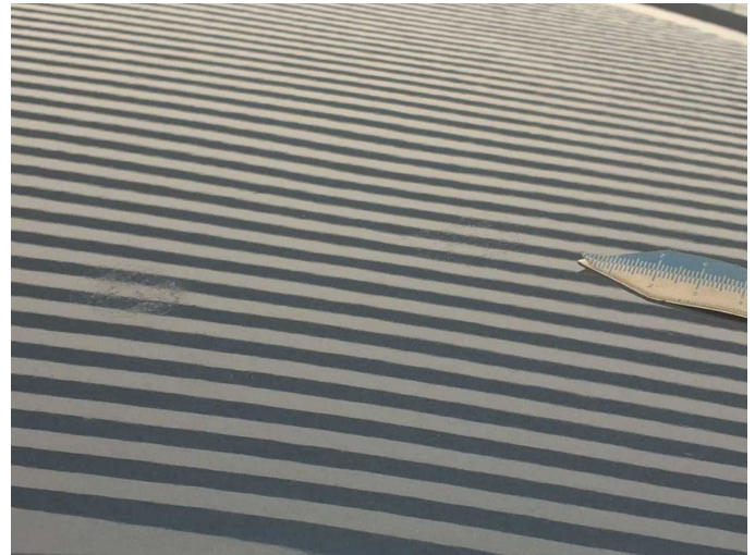
Damage 10: Roof: Roof (Verätzungen) - Paint defect - Paint
