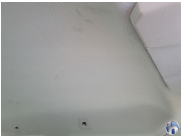
7. Dachhimmel Verschmutzt - Reinigen
