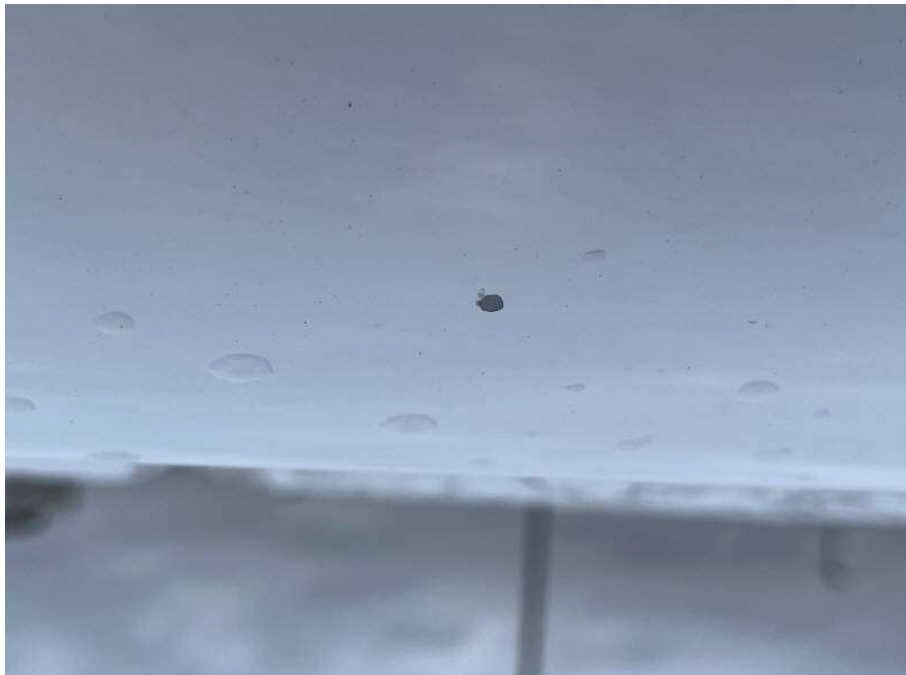
Bild 49 Dachholm rechts Steinschläge/ Lackabplatzung
