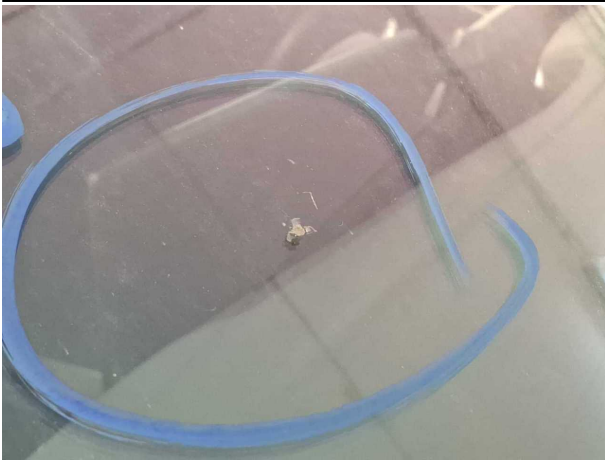
Beschädigung #5: Verglasung: Frontscheibe - Steinschlag - erneuern
