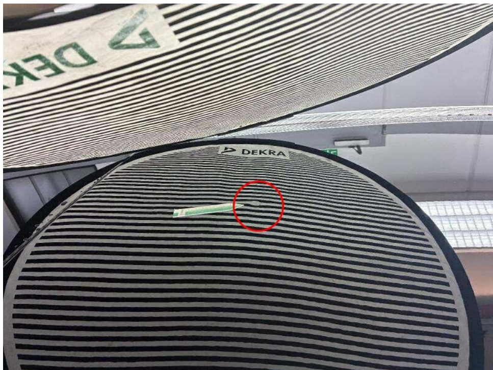
Bild 24 : Dach, eingedellt, drücken
