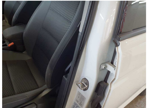
Beschädigung #3: Tür vorn links: Türdichtung - porös / rissig - erneuern
