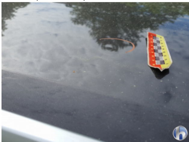
6. Dach Gebrauchsspuren - Ohne Reparatur
