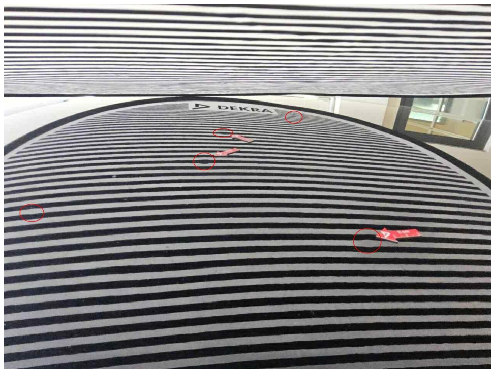
Bild 24 : Dach mehrfach eingedellt
