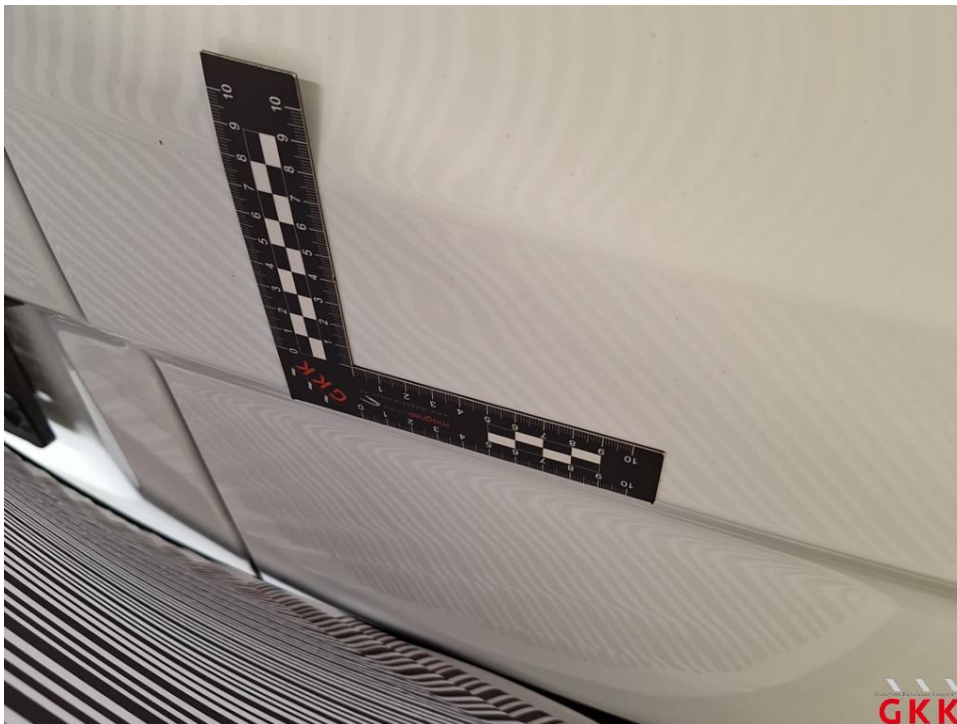
Bild 22 Hecktür rechts, beschädigt, instand setzen - lackieren
