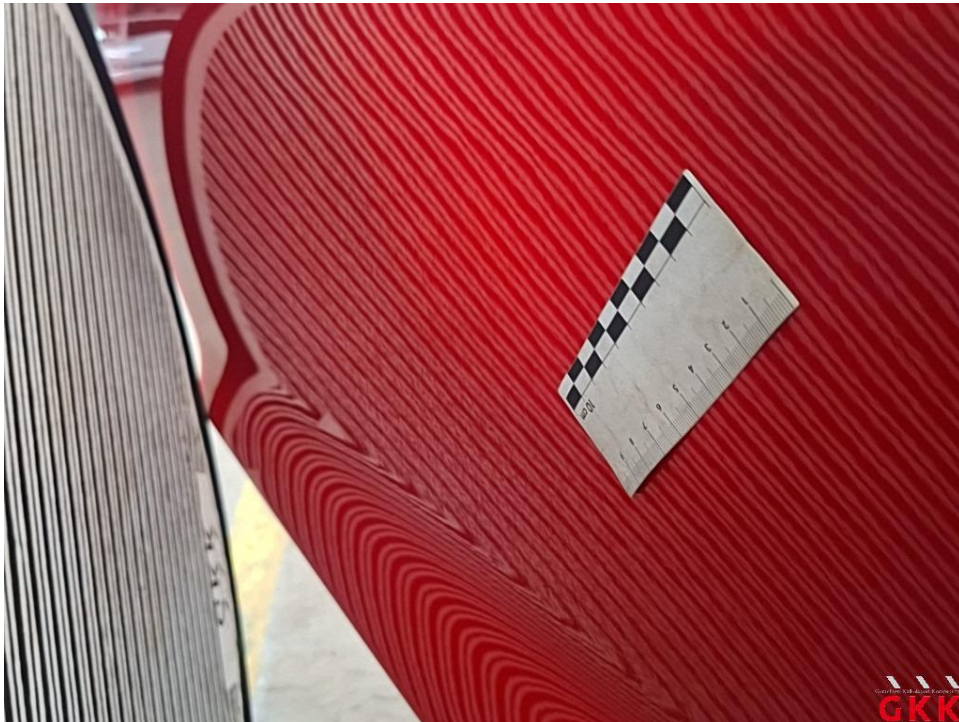
Bild 48 Tür vorne rechts, Reparaturmangel, instand setzen - lackieren
