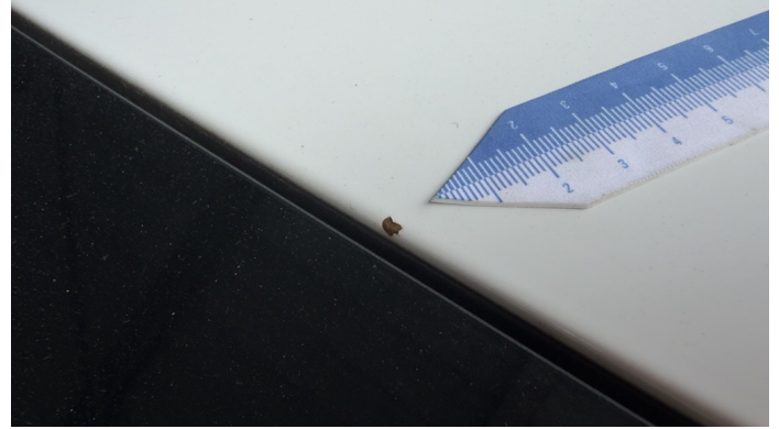
Damage 7: Roof: Roof (Dachkante, Steinschlag mit Korrosionsbeginn) - Corrosion - Repair and paint
