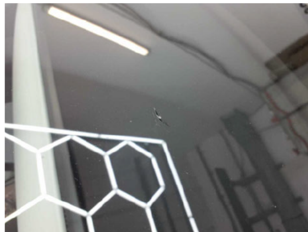
Beschädigung #9: Verglasung: Frontscheibe - gebrochen / gerissen - erneuern
