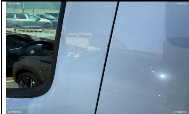
Foto daños externos 1
