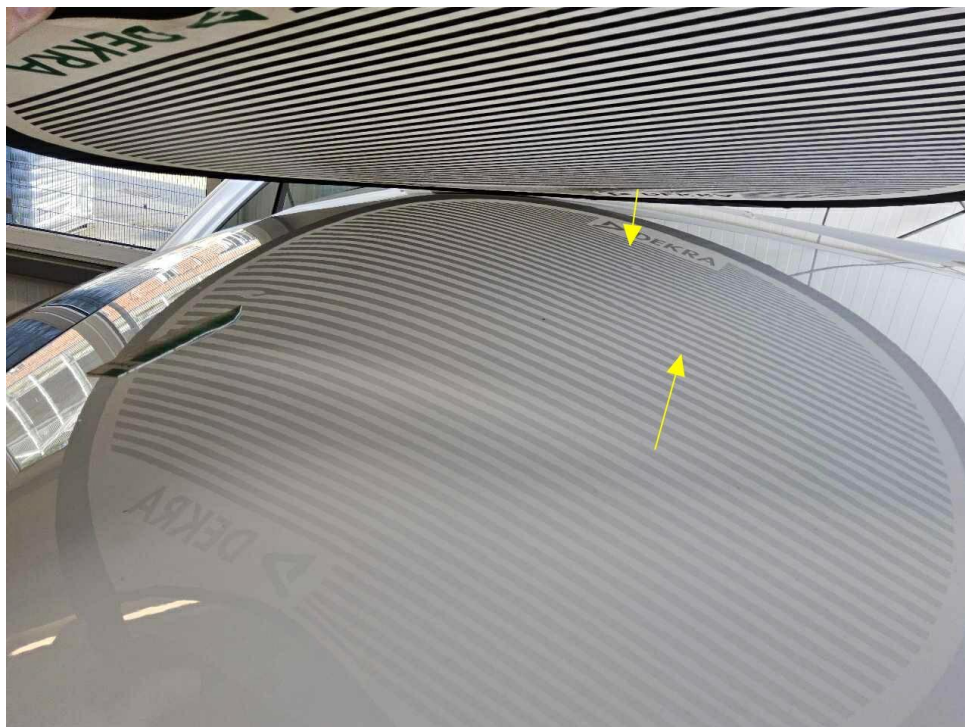
Bild 24 : Dach, mehrfach eingedellt, drücken
