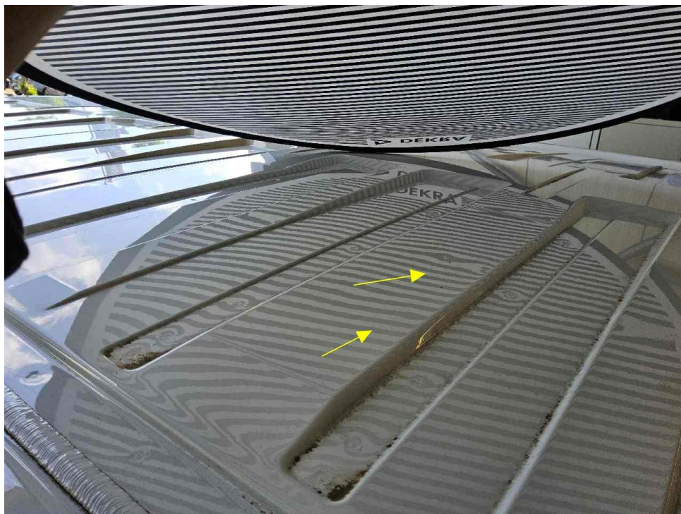
Bild 25 : Dach, mehrfach eingedellt, drücken
