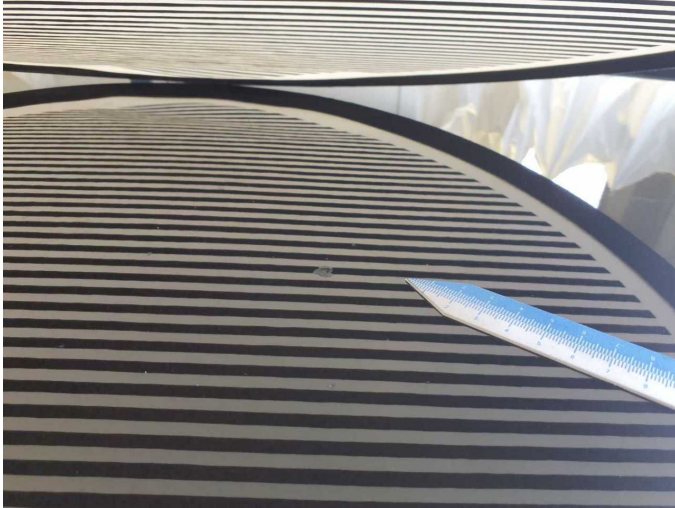
Damage 9: Roof: Roof (Anätzung-Mehrkosten möglich) - Paint defect - Conditioning
