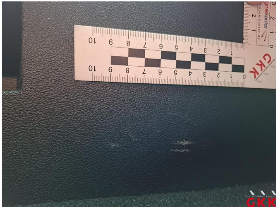
Bild 27. Ladekante, Abdeckung, verkratzt, ersetzen
