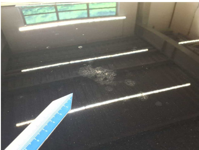
Damage 7: Roof: Roof (Verätzungen + Kratzer) - Paint defect - Paint
