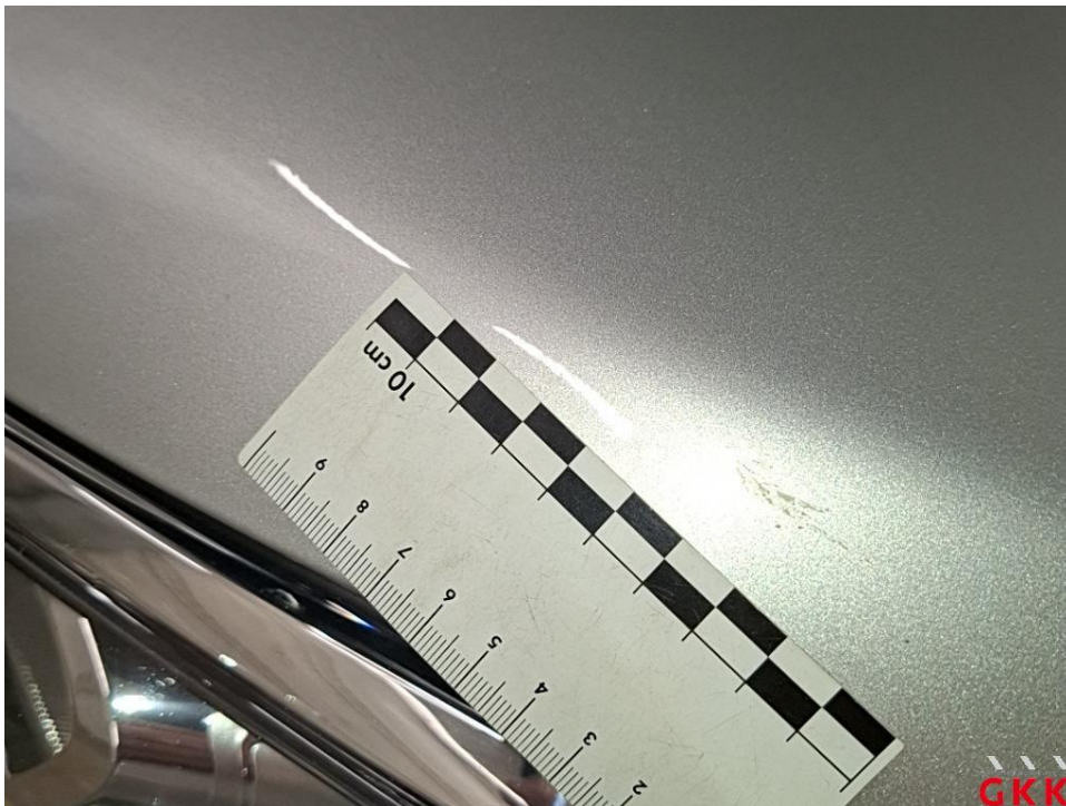
Bild 20 Motorhaube, Steinschlag und Kratzer, lackieren
