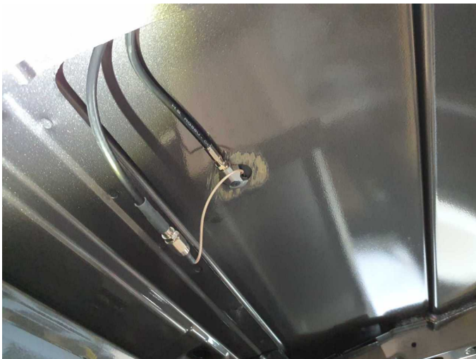
Damage 1: Roof: Aerial (Kabelstrang in Verbindung mit Dach entfernen) - Perform
