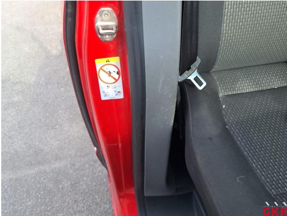
Bild 11. B- Säule rechts, Innenverkleidung -unterhalb-, verkratzt, ersetzen
