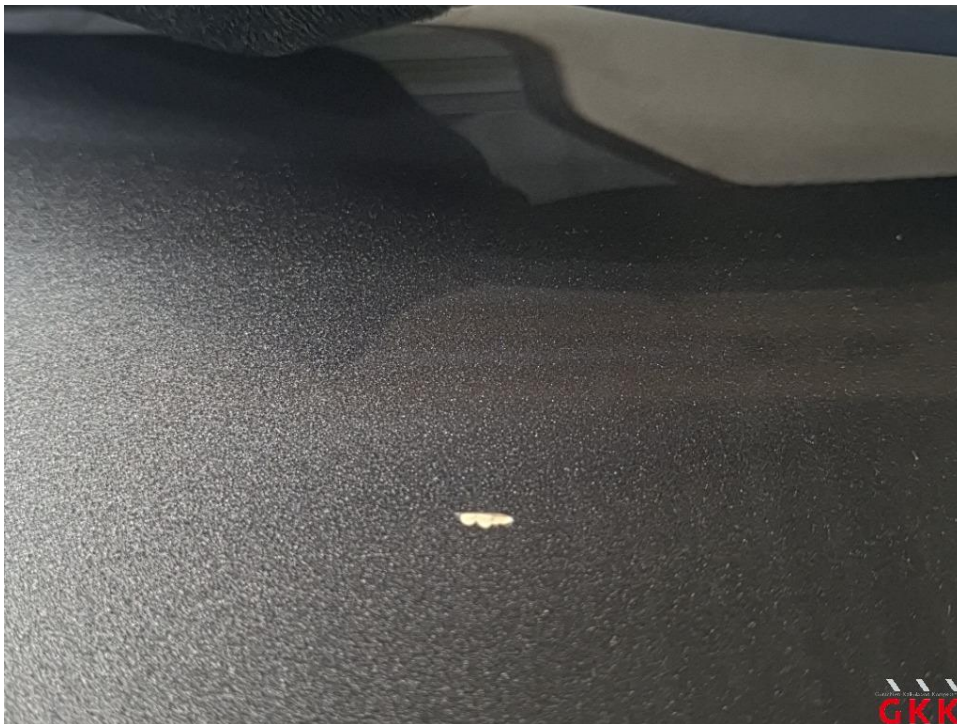
Bild 47 Dach, verkratzt, lackieren
