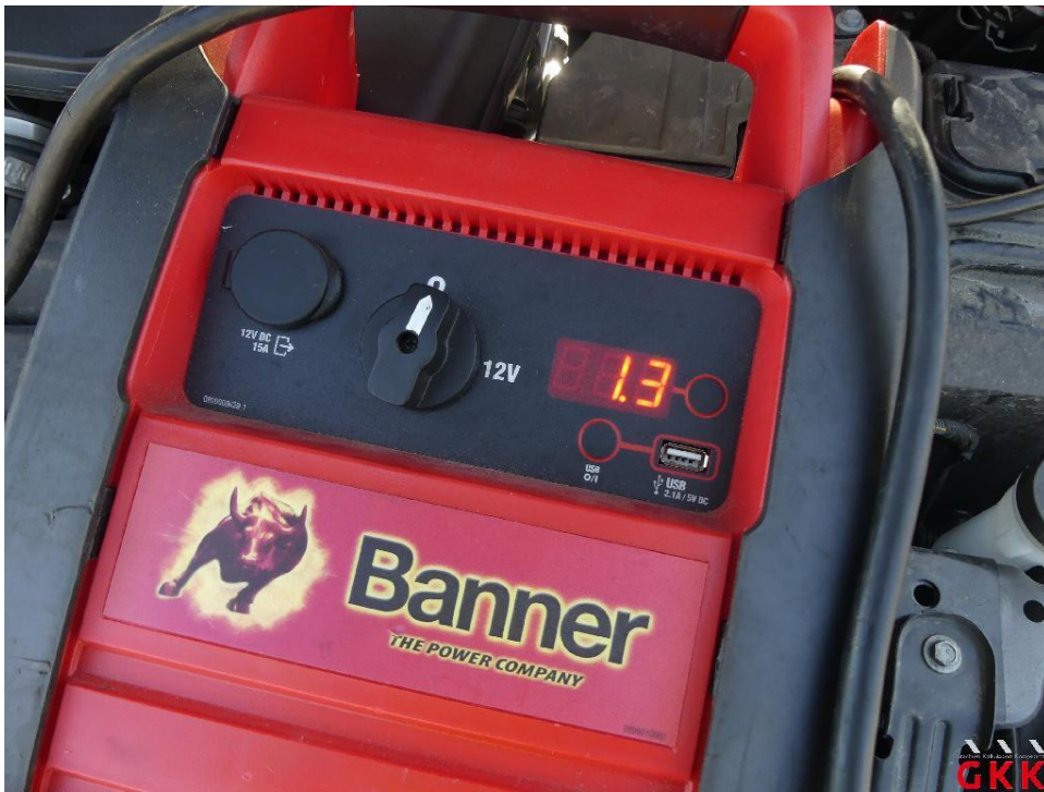
Bild 18 Fahrzeug, Batterie, funktionsuntüchtig, ersetzen
