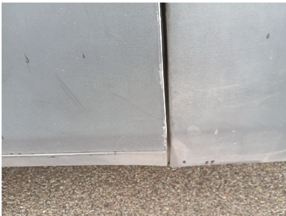
Bild: 18 Tür links Beplankung deformiert
