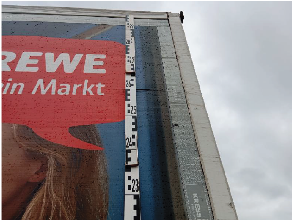
Bild: 27 Übersicht Schadenbereich mit Geometerstab
