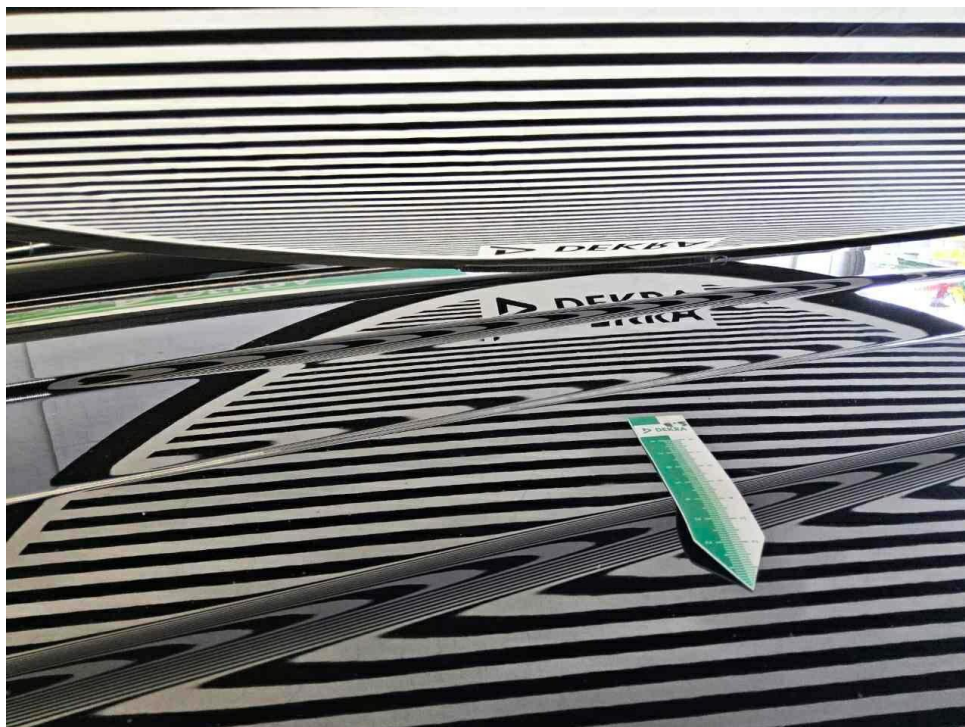
Bild 22 : Dach, eingedellt, Gebrauchsspur
