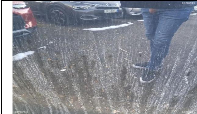
Foto daños externos 1
