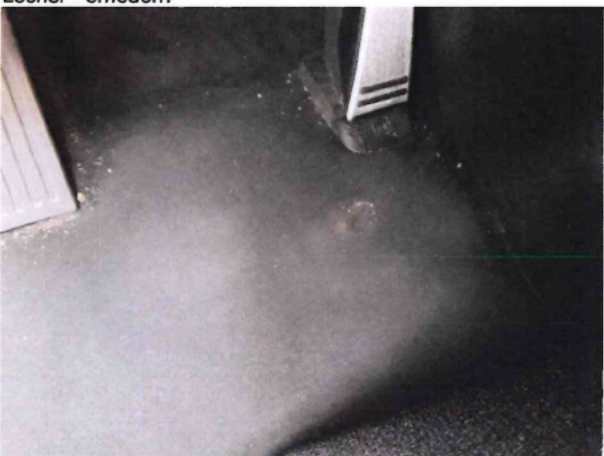
Beschädigung #2: Verkleidungen/Abdeckungen: Fußmatten - Löcher - erneuern
