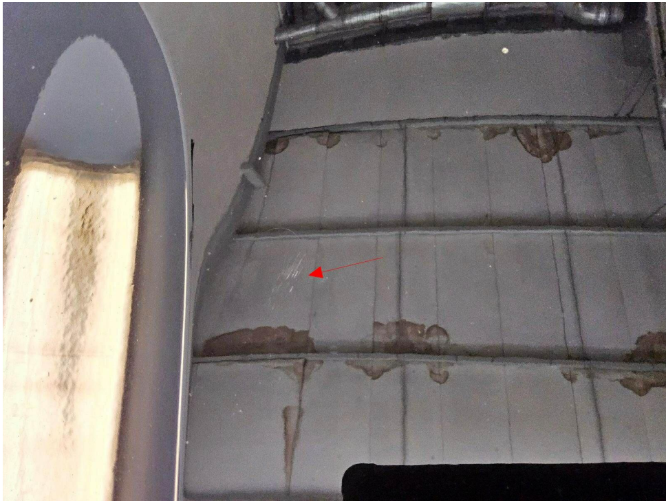
Bild 12 : Deckel vorne verschrammt
