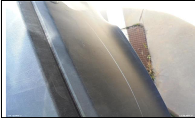
Foto daños externos 1
