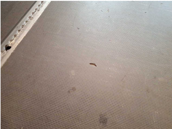
Beschädigung #20: Interieur: Laderaumboden - beschädigt - instandsetzen
