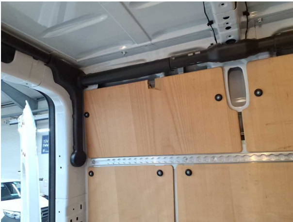
Beschädigung #2: Seitenwand links: Innenverkleidung - beschädigt - erneuern
