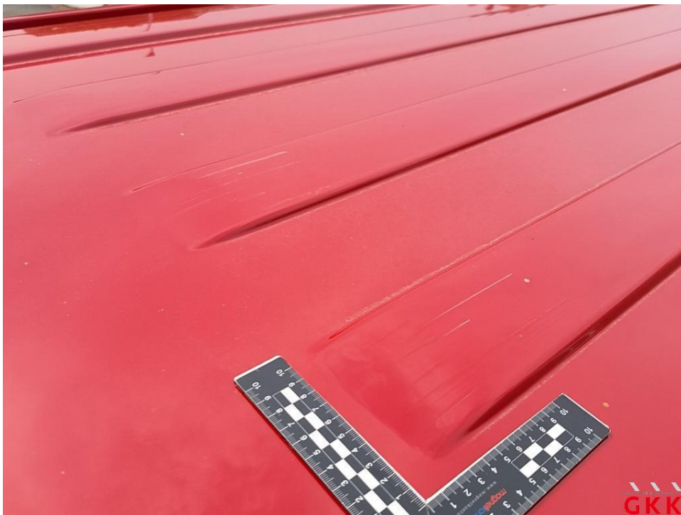
Bild 32. Dach, beschädigt, instand setzen
