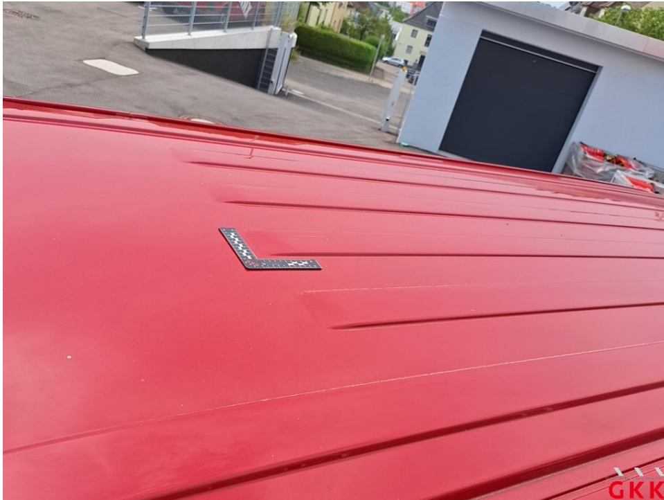
Bild 31. Dach, beschädigt, instand setzen
