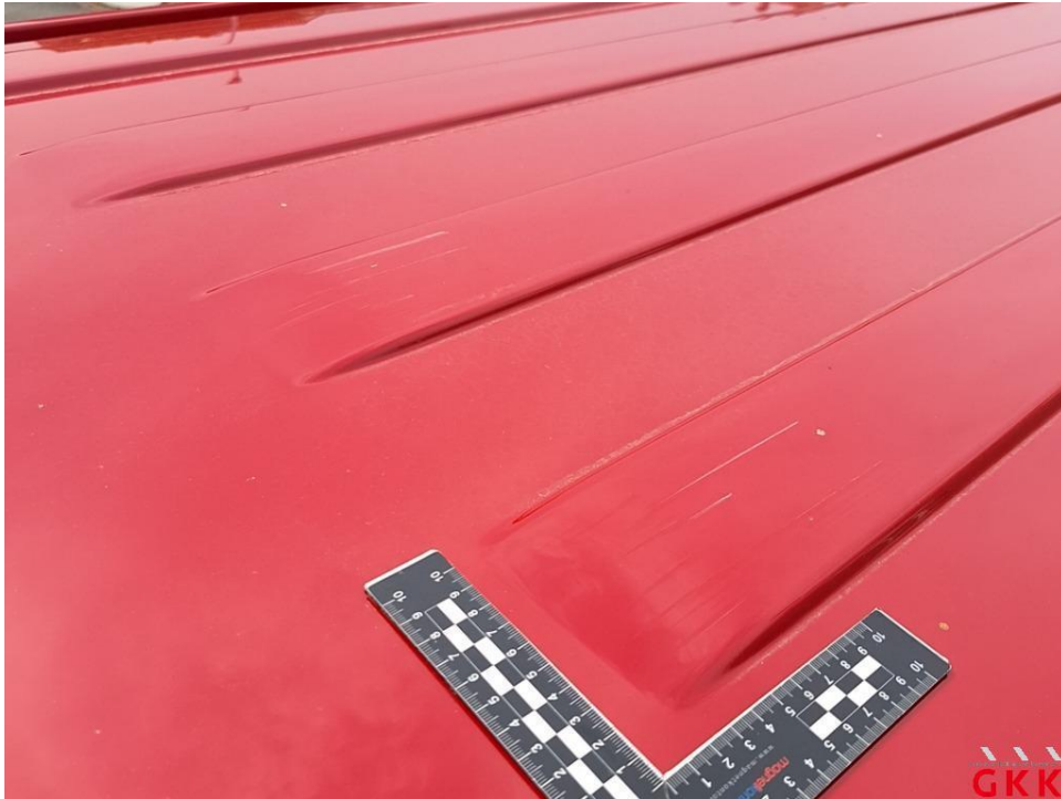
Bild 35. Dach, verkratzt, lackieren
