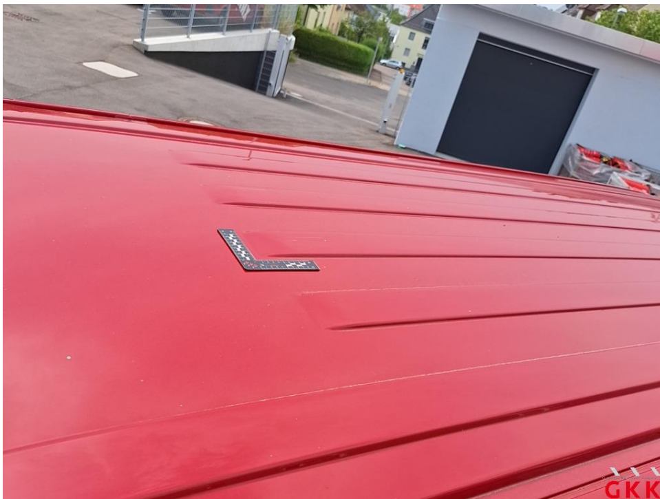
Bild 34. Dach, verkratzt, lackieren
