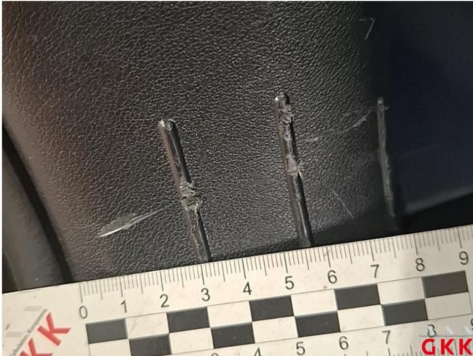
Bild 51. Seitenwand links, Innenverkleidung, verkratzt, ersetzen
