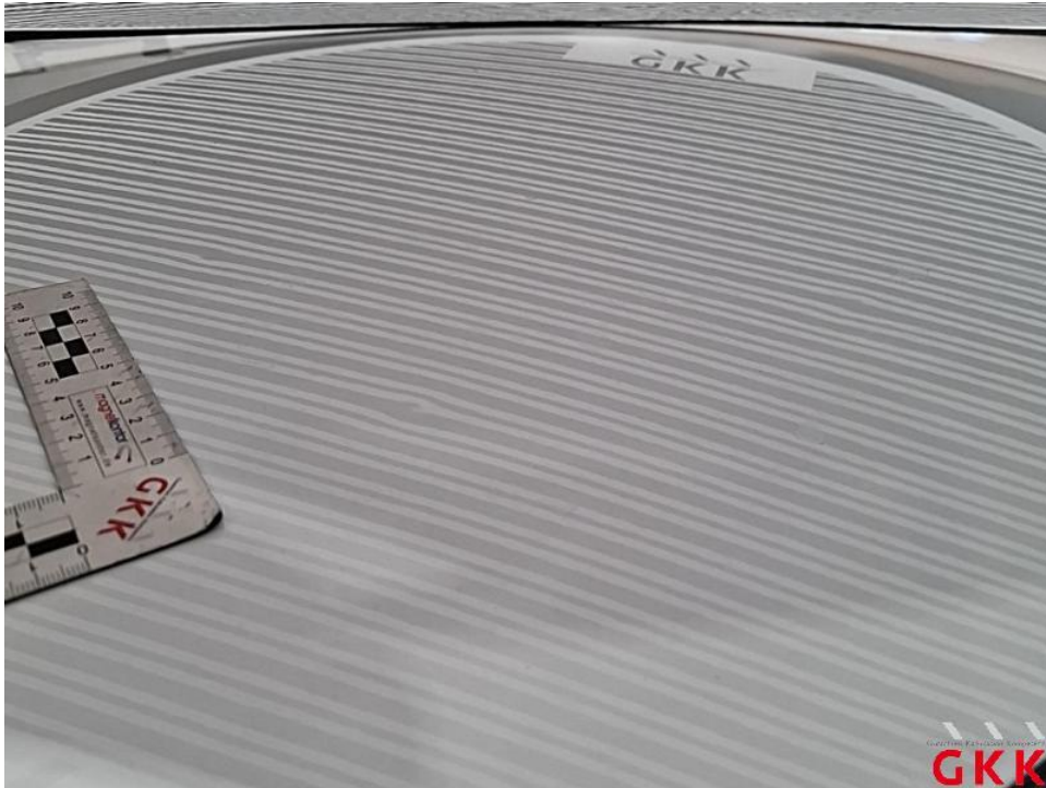
Bild 43. Dach, Hagelschaden, kalt drücken
