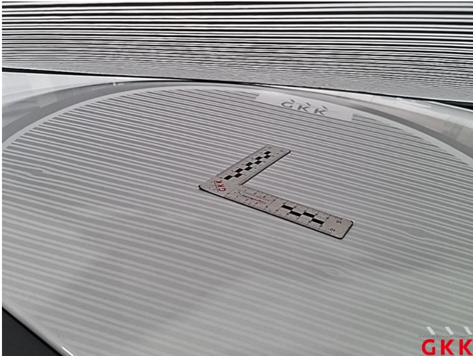
Bild 44. Dach, Hagelschaden, kalt drücken
