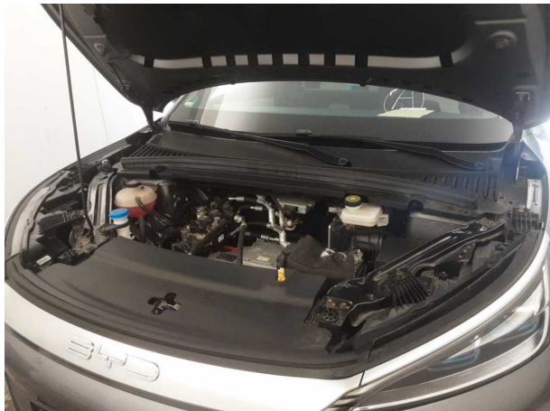
Beschädigung #1: elektrisches System: Batterieabdeckung - Marderschaden - erneuern
