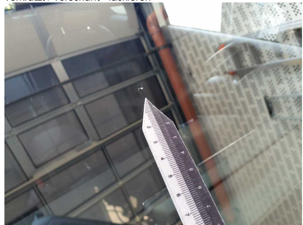
Beschädigung #7: Verglasung: Frontscheibe (mit Rissbildung) - Steinschlag - erneuern
