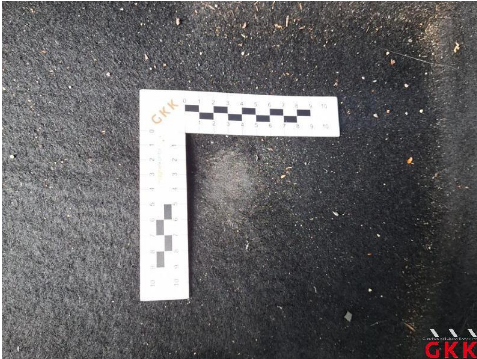
Bild 45. Teppich, beschädigt, ersetzen
