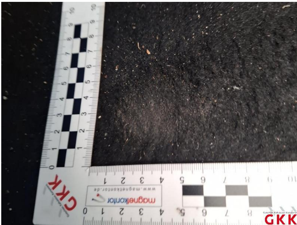
Bild 46. Teppich, beschädigt, ersetzen
