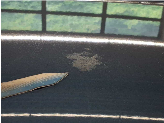
Damage 8: Roof: Roof (Verätzung) - Paint defect - Paint
